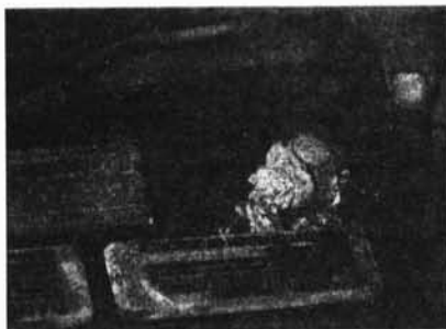
20.8a Коррозия клемм батареи обычно проявляется в виде легкого, рыхлого порошка
