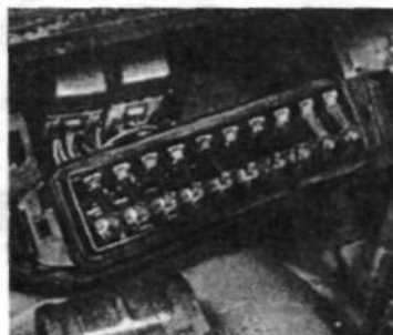
11.15. Коробка предохранителей (FIAT 1300 GT).
