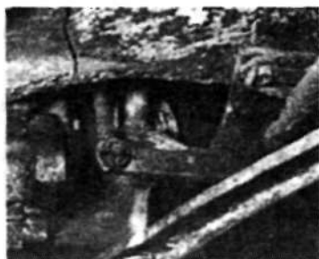
2.17 А Передние болты, отвернутые от балки
